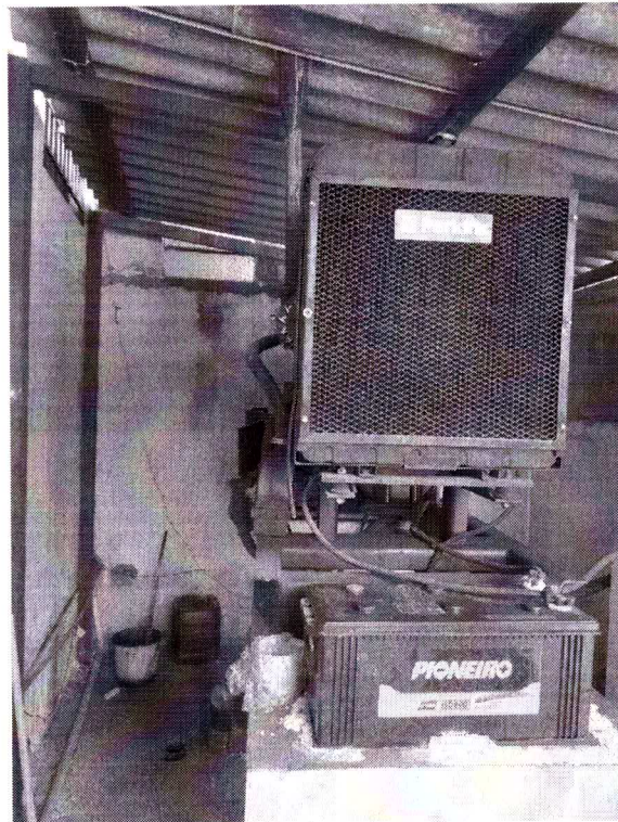
Figura 1 – Grupo gerador frontal.
