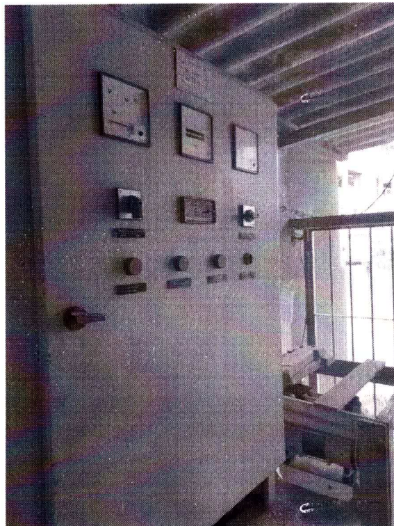
Figura 7 – Quadro de Transferência Automático (QTA) fechado.
